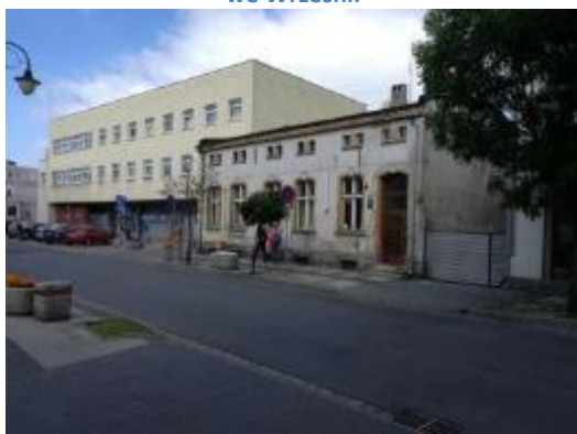
Zdjęcie 20 Zabytkowe kamienice we Wrześni. Przykład nieudanej renowacji budynku.
