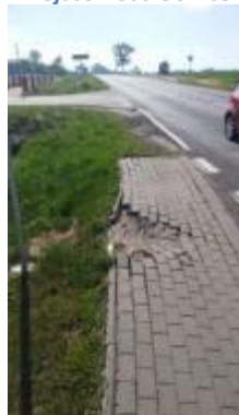
Zdjęcie 74 Ubytek w poboczu w pobliżu ścieżki. Miejscowość Gonice.
