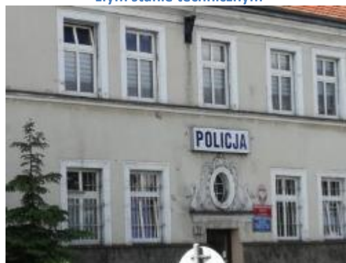
Zdjęcie 15 Elewacja budynku Komendy Powiatowej Policji w złym stanie technicznym
