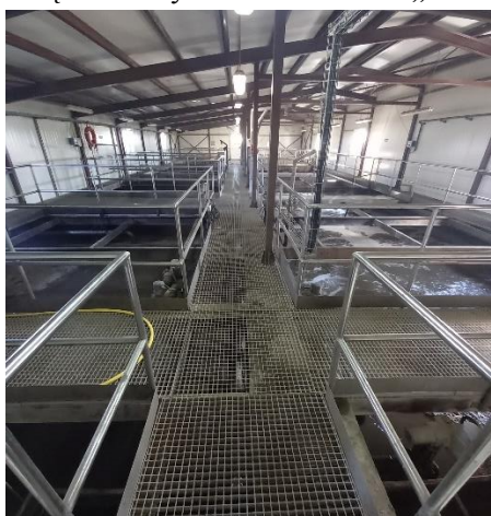
Fot. 37. Wnętrze Oczyszczalni ścieków „POMILTEK” w Radymnie
