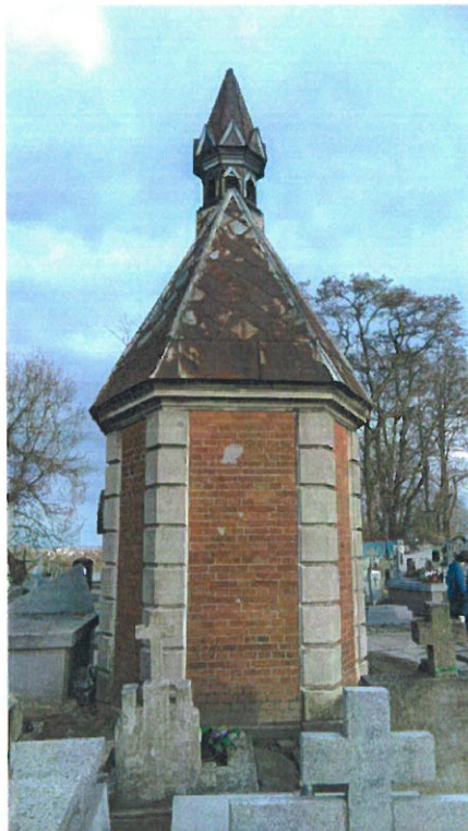
Zdjęcie nr 4 – Elewacja zachodnia – widoczne skorodowane pokrycie dachu oraz zawilgocone ściany.
