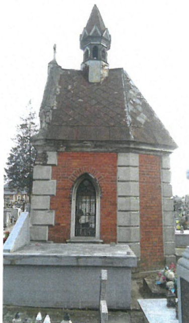
Zdjęcie nr 2 – Elewacja północna – widoczne skorodowane pokrycie dachu oraz zawilgocone ścian.
