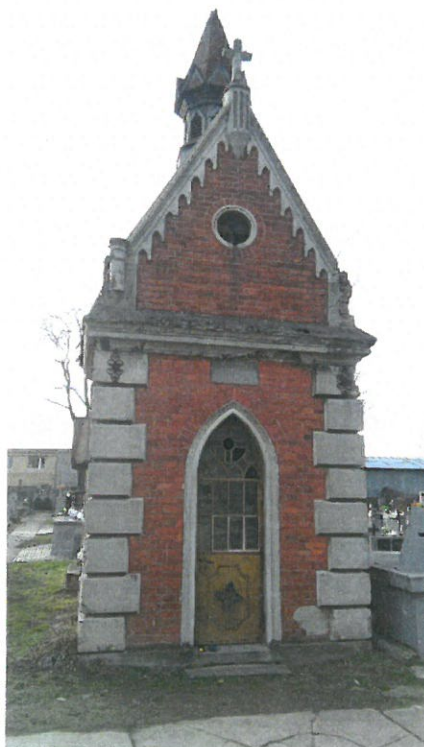
Zdjęcie nr 3 – Elewacja wschodnia – widoczne ubytki tynku na boniach oraz gzymsie.
