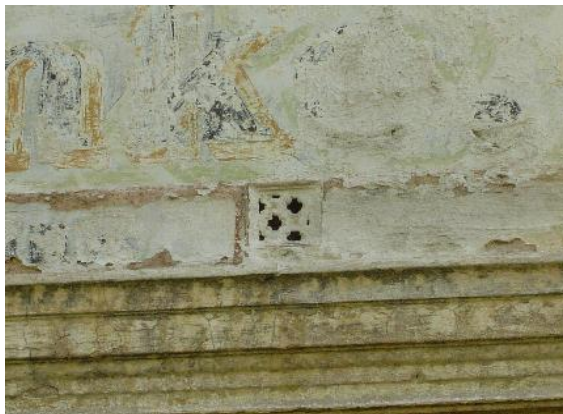
Ozdobna kratka wentylacyjna w budynku mieszkalnym
