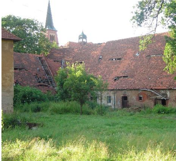
Zabudowania dawnego folwarku. Obecnie w ruinie-zabudowania wymagają odbudowy.
