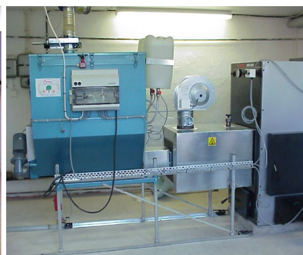
Farmheat t120 + zbiornik 600l. z przepustnicą
