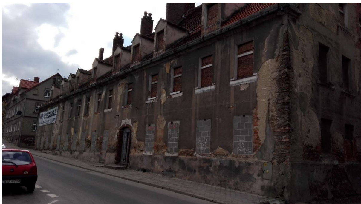
Fot. 4. Zdegradowany obiekt przy Placu Piastów Śląskich w Piławie Górnej
