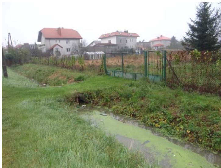
Ryc. 262. Zatkane przepusty pod dojazdami do posesji ograniczające przepustowość rowów przydrożnych
