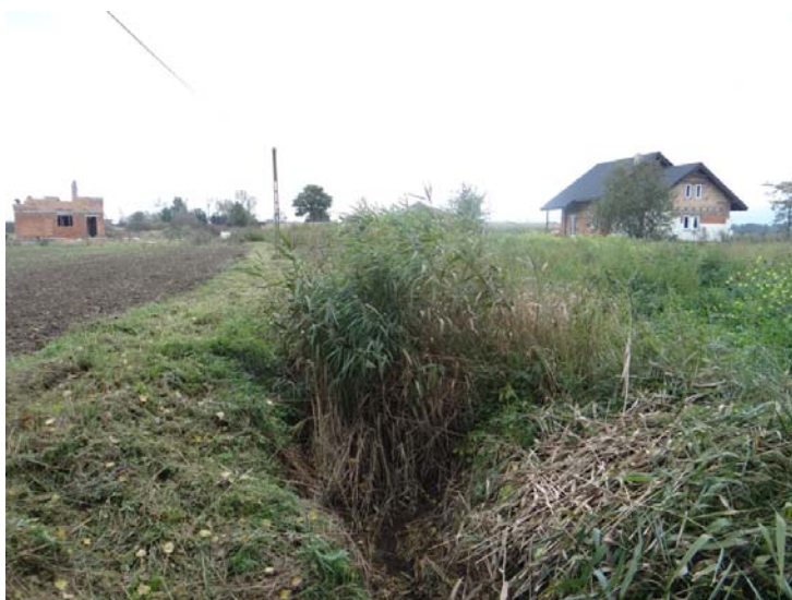
Ryc. 259. Zarośnięty rów melioracyjny – ograniczona przepustowość rowu
