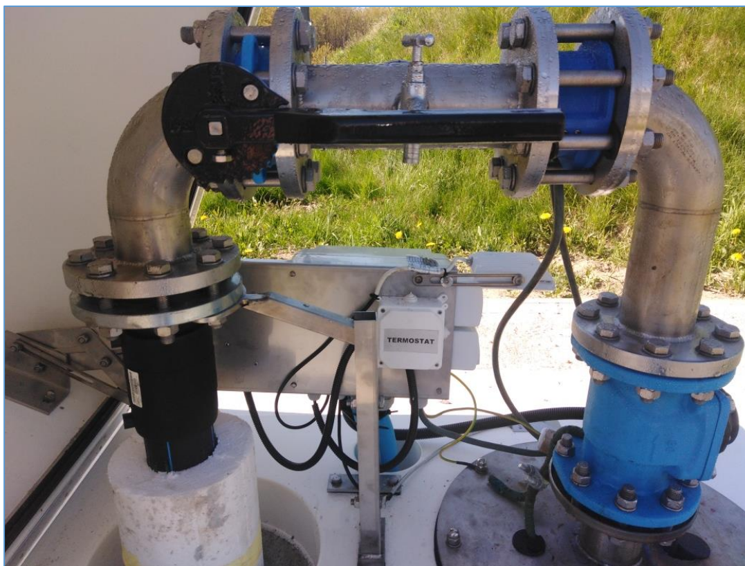
Zdjęcie: Zmodernizowana studnia głębinowa S1
