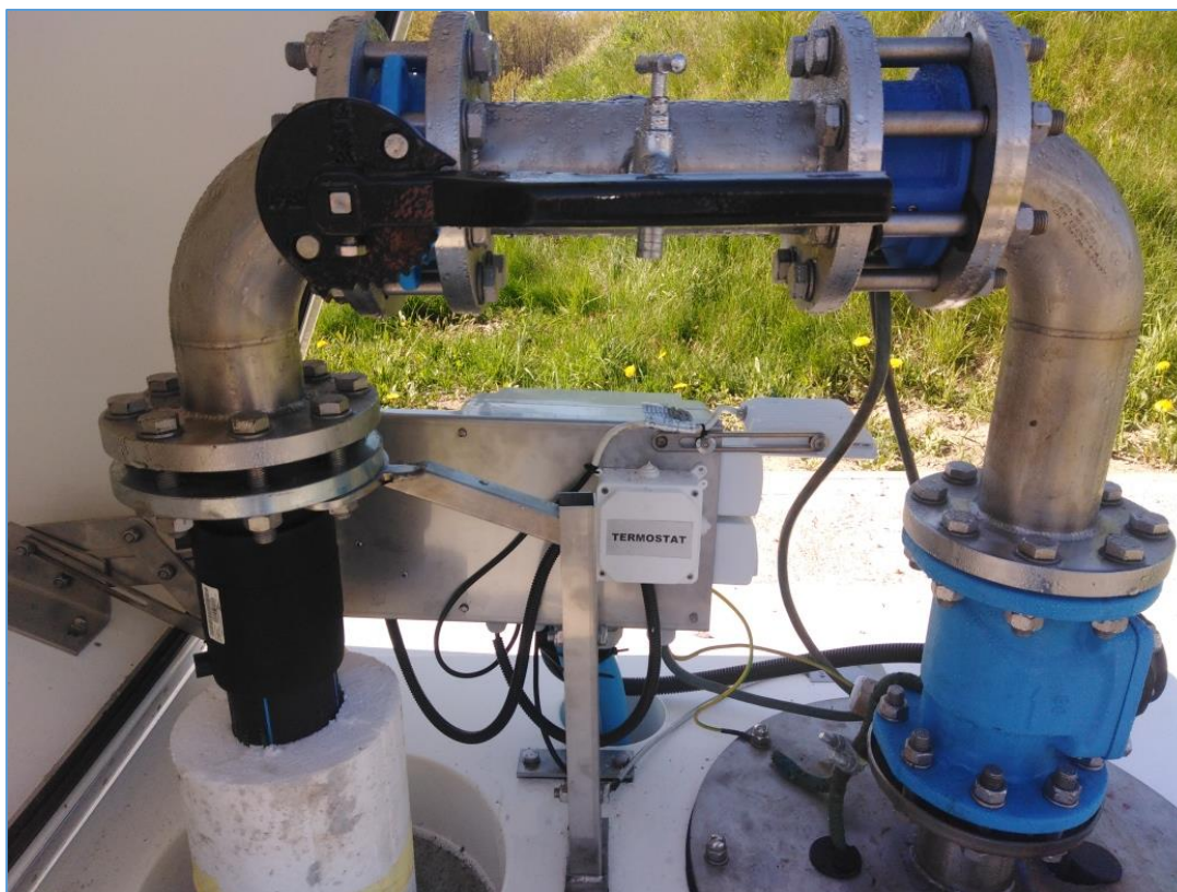
Zdjęcie: Zmodernizowana studnia głębinowa S1
