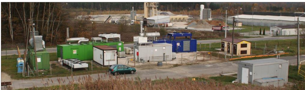
fot. Instalacja pozysku i energetycznego wykorzystania biogazu składowiskowego
