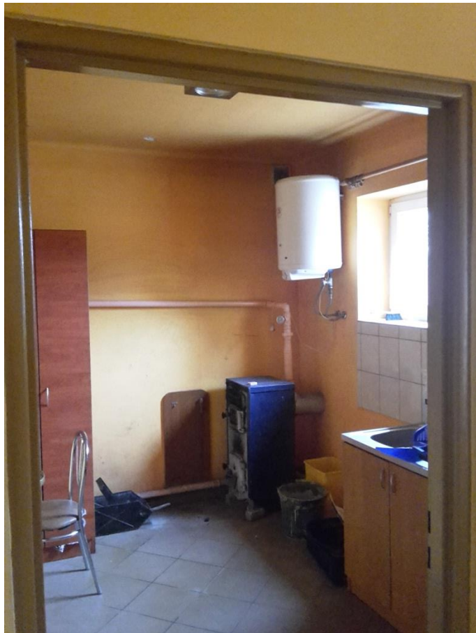
[Fot. 4 – pomieszczenie pomocnicze z kotłem ogrzewczym]
