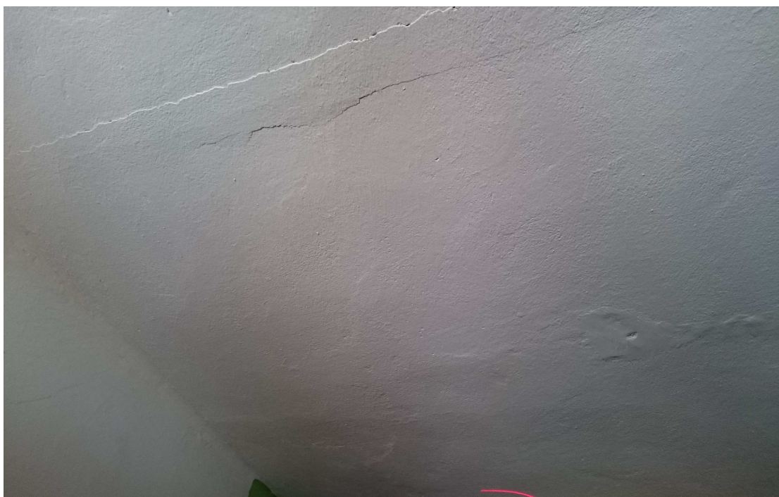
Widoczne pęknięcia na suficie
