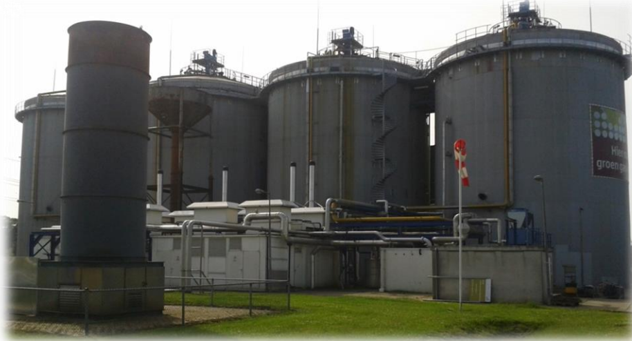
Rys. 21. Komory fermentacyjne biogazowni Autor: Dariusz Koc
