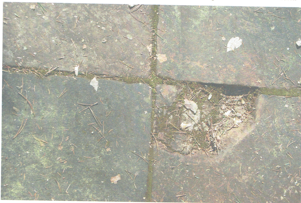
Fragment z uszkodzeniami
