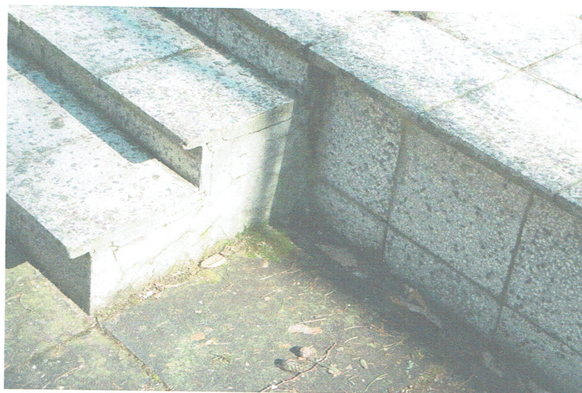
Brak nawisów bocznych schodów.
