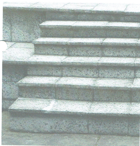
Widoczne naprawy uszkodzeń płytek.
