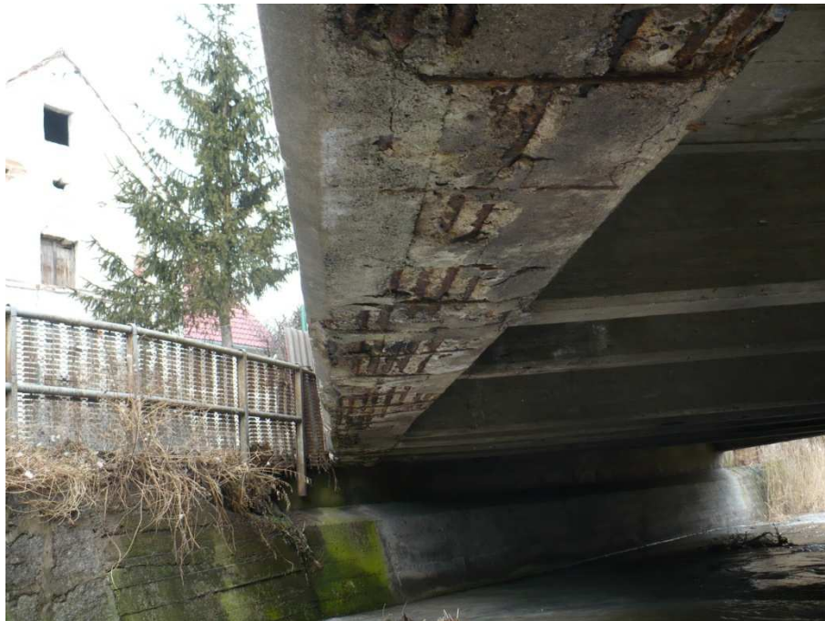
Fot.1 – Odślonięte zbrojenie główne dźwigarów
