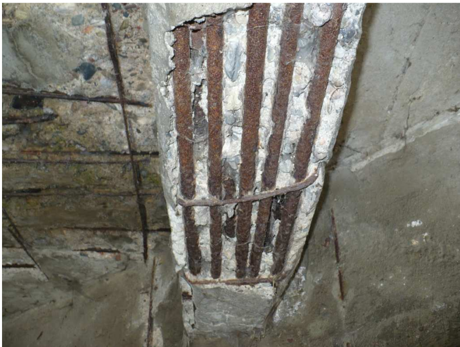
Fot.3 – Odślonięte zbrojenie główne żebra poprzecznego ( element rusztu) – skutki braku izolacji płyty
