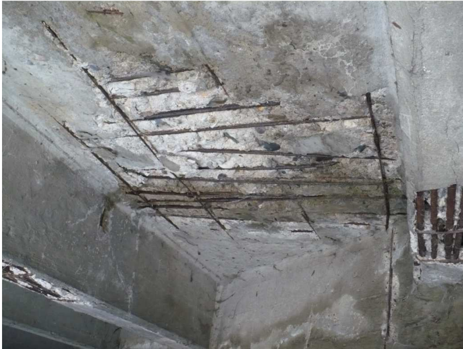
Fot.2 – Odślonięte zbrojenie główne płyty pomostu – skutki braku izolacji płyty
