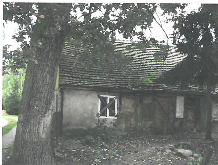
fot.2 fragment elewacji zachodniej (widoczne ubytki w elementach konstrukcji ścian zew. oraz odkształcenie konstrukcji dachu, ubytki w pokryciu dachu.)
