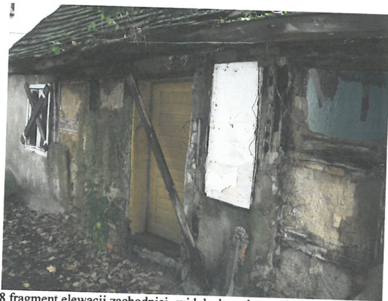
fot.8 fragment elewacji zachodniej- widok skorodowanej biologicznie ściany zew. o konstrukcji szachulcowej ,ubytki wypełnienia w ścianie
