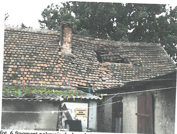
fot. 6 fragment pokrycia dachu od strony wschodniej- widoczne duże ugięcie ,zarwany dach , znaczne ubytki w pokryciu dachu z dachówek, obłuzowania
