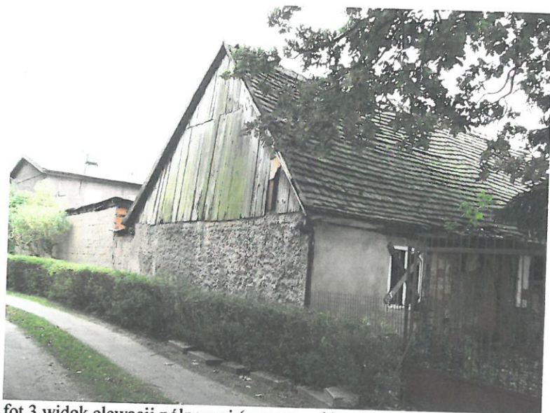
fot.3 widok elewacji północnej (szczytowej) -widoczne ubytki w elementach konstrukcji drewnianej ściany zew.
