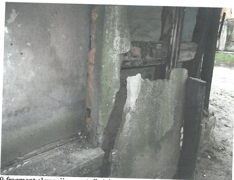
fot.9 fragment elewacji : narożnik ściany zachodnio-południowej - widok skorodowanej biologicznie ściany zew. o konstrukcji szachulcowej ,ubytki wypełnienia w ścianie
