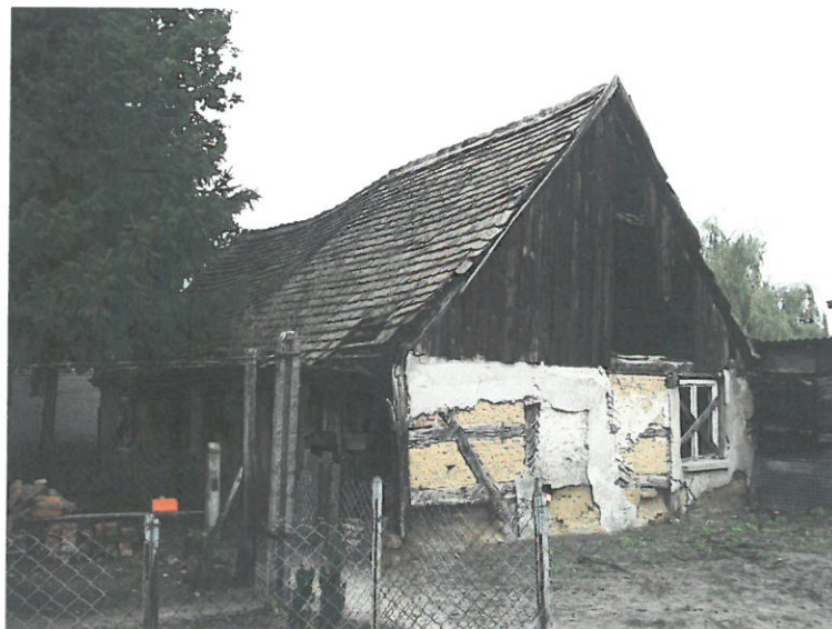
fot. 1 widok elewacji południowo-zachodniej (widoczne ubytki w elementach konstrukcji ścian zew. oraz odkształcenie konstrukcji dachu, ubytki w pokryciu dachu.)
