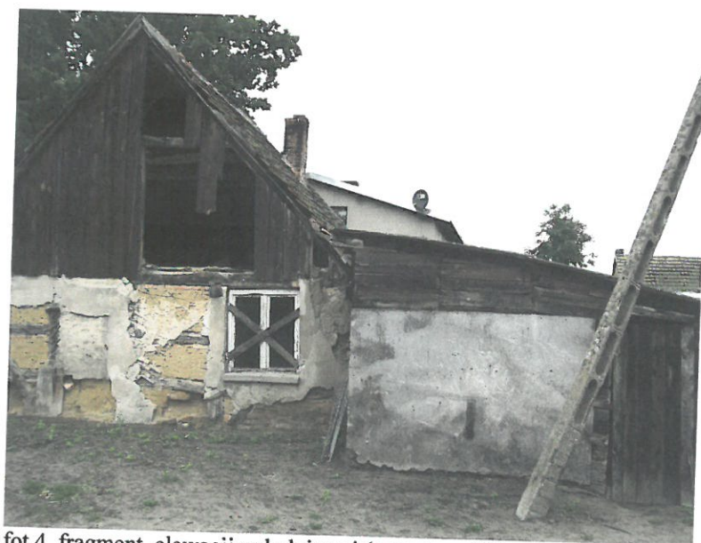
fot.4 fragment elewacji południowej (szczytowej) budynku mieszkalnego wraz z przybudówką- widoczne ubytki , odkształcenia w ścianach zew.
