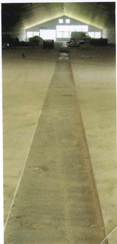
Rys. 6 Kanał odprowadzający wodę z mycia kurnika
