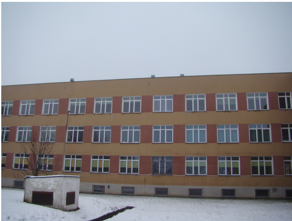
Fot. 20. Okna w suterenie (ściana południowa budynku średniego).
