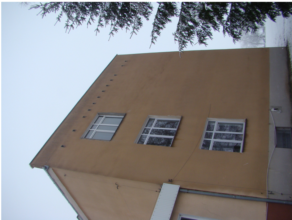
Fot. 13. Dwanaście otworów wentylacyjnych bez kratek na zachodniej ścianie budynku średniego w kształcie litery L.
