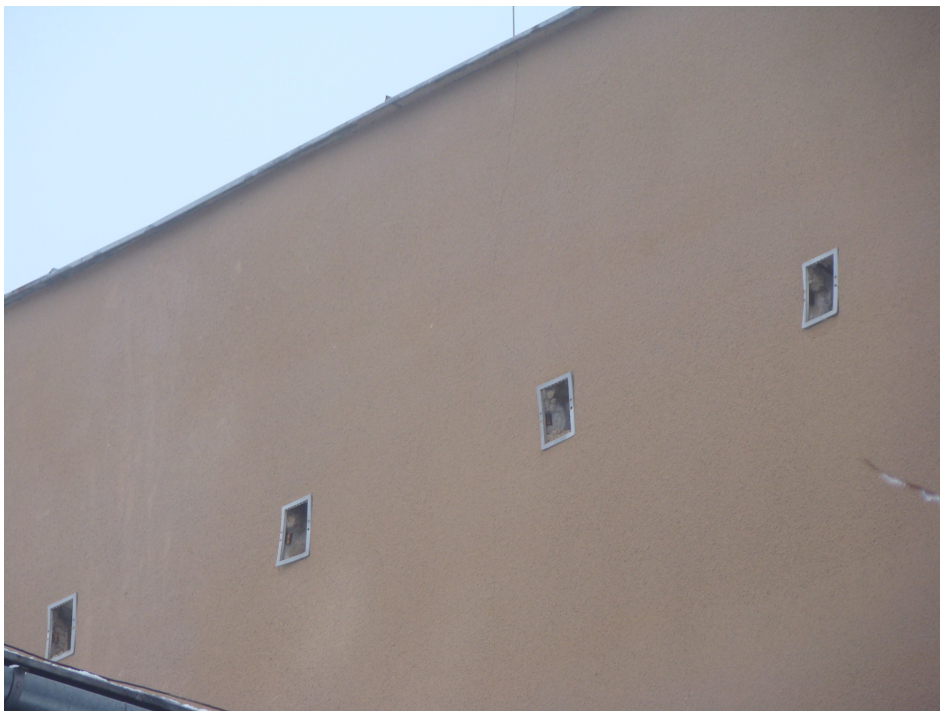
Fot. 11. Brak kratki zabezpieczających otwory wentylacyjne na ścianie średniego budynku od strony południowej.
