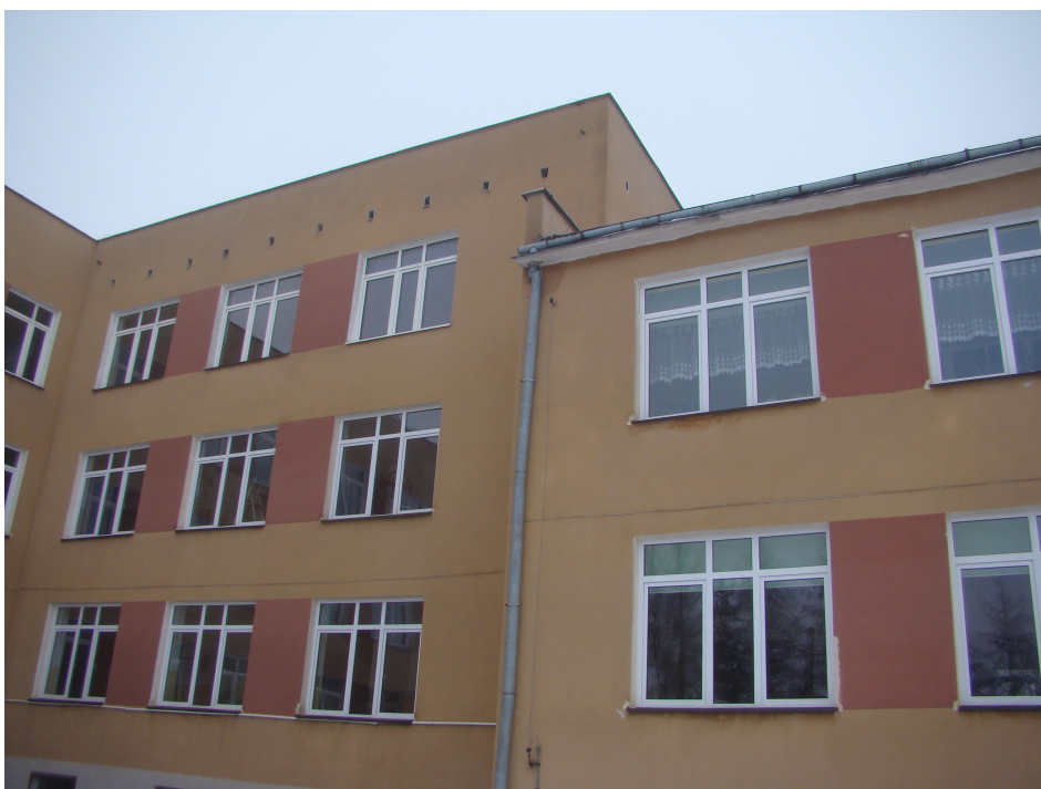
Fot. 12. Dziesięć otworów wentylacyjnych bez kratki na zachodniej ścianie budynku średniego w kształcie litery L.
