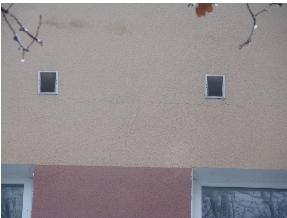
Fot. 8. Nie zabezpieczone otwory wentylacyjne na wschodniej ścianie budynku.
