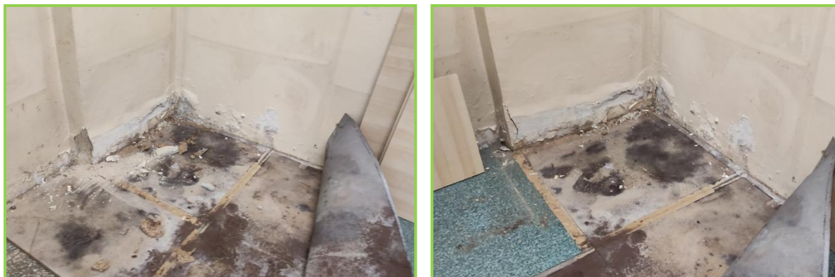
Zdjęcia 13-14. Stan podłóg w pomieszczeniach GOK w Czerminie przed remontem
