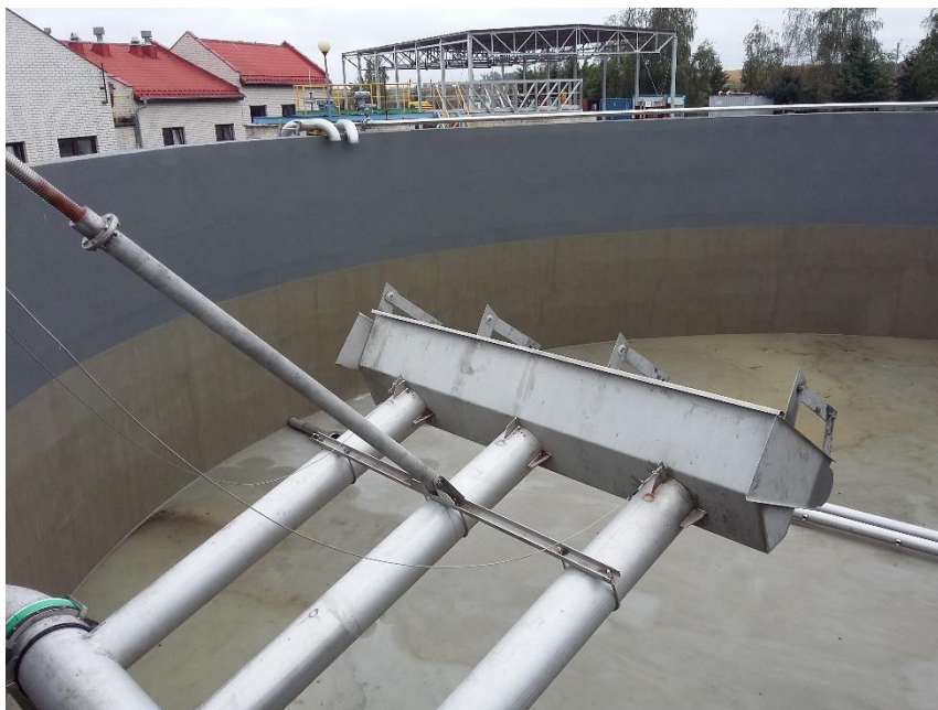
Rysunek 17. Zmodernizowana oczyszczalnia ścieków
